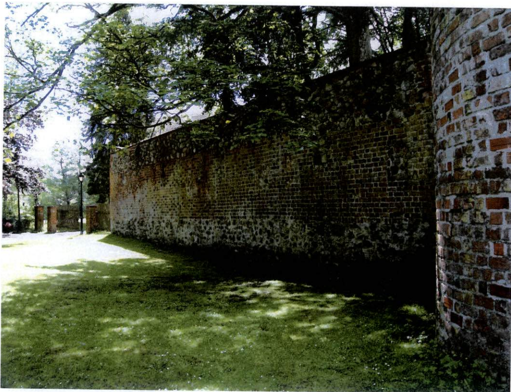
fot.38. Mur północny – widok części wschodniej. Mur zachowany bez uszkodzeń, z wyjątkiem ubytków zaprawy.
