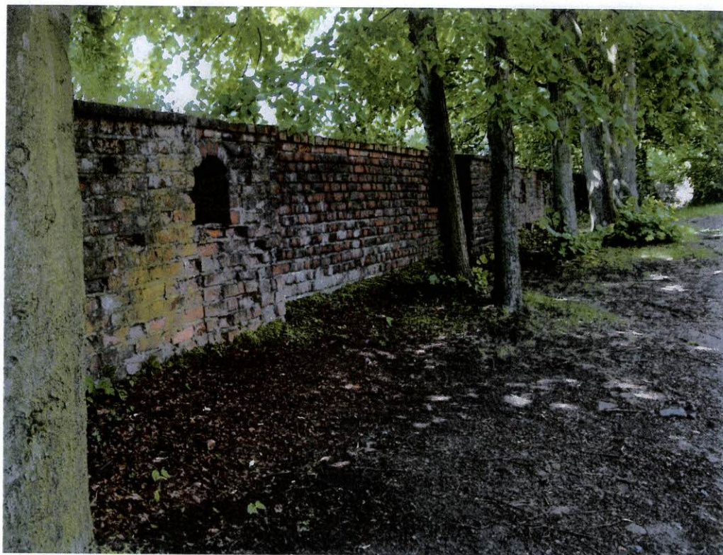
fot.19. Mur południowy – mur z cegły w widoku od strony wewnętrznej. Widoczne liczne drzewa rosnące w bezpośrednim sąsiedztwie muru i systemem korzeniowym uszkadzające mur. W murze ceglany część cegieł jest skorodowanych z głębokimi ubytkami. W murze widoczne głębokie ubytki zaprawy. W murze są widoczne pionowe i ukośne spękania o niewielkiej rozwarłości.
