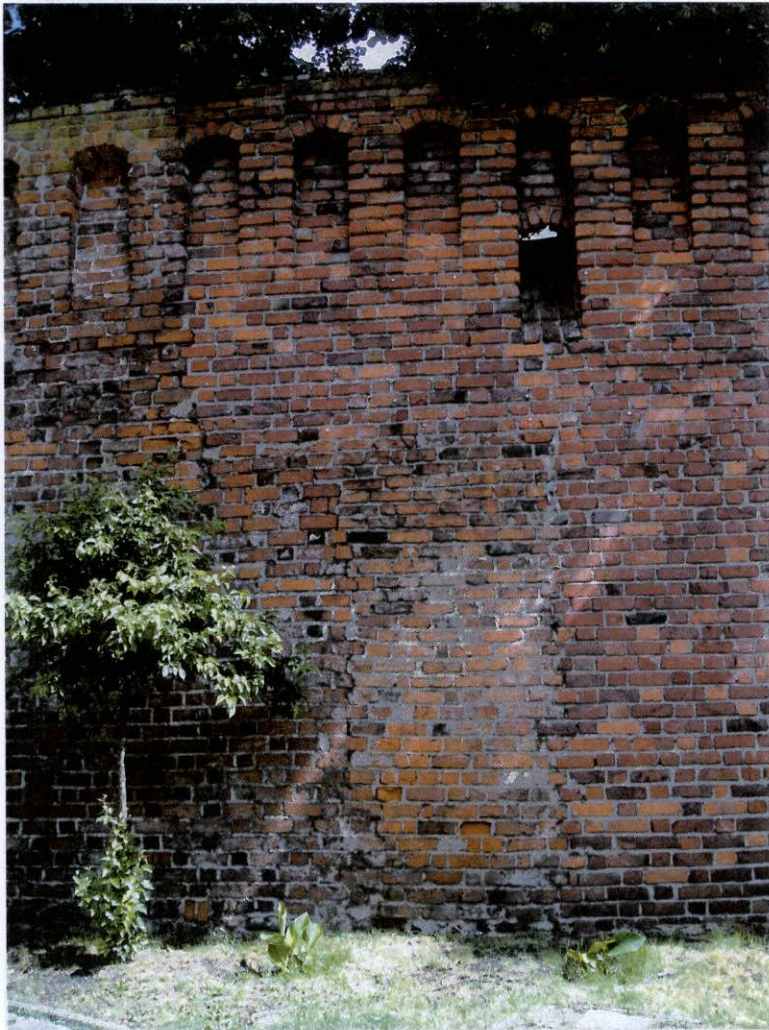
fot.17. Mur południowy – fragment środkowy muru. Widoczne pęknięcia i zarysowania muru o przebiegu pionowym i ukośnym, o niewielkiej rozwarłości. Widoczne ślady po zatarciu zaprawą części pęknięć.
