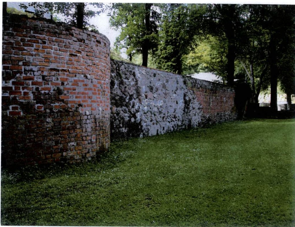
fot.39. Mur północny – widok części środkowej muru. Na pierwszym planie dolna zachowana część bastionu. W bastionie górą i dołem cegły częściowo skorodowane z ubytkami, miejscami głębokie ubytki zaprawy. W środkowej partii jaśniejszy odcinek muru, wykonany współcześnie z kamieni łamanych.
