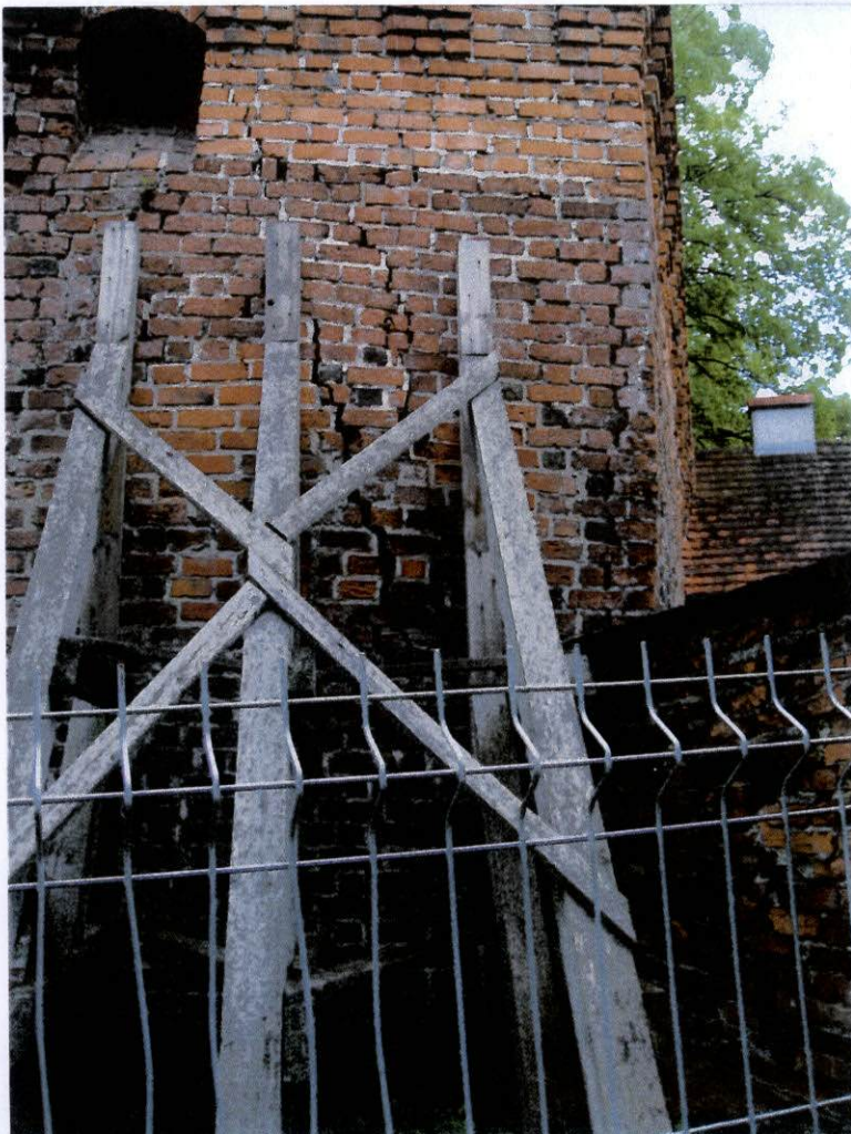
fot.8. Naroże południowo – zachodnie – fragment środkowy muru południowego w pobliżu naroża. Widoczne pionowe pęknięcia muru o znacznej rozwarości.
