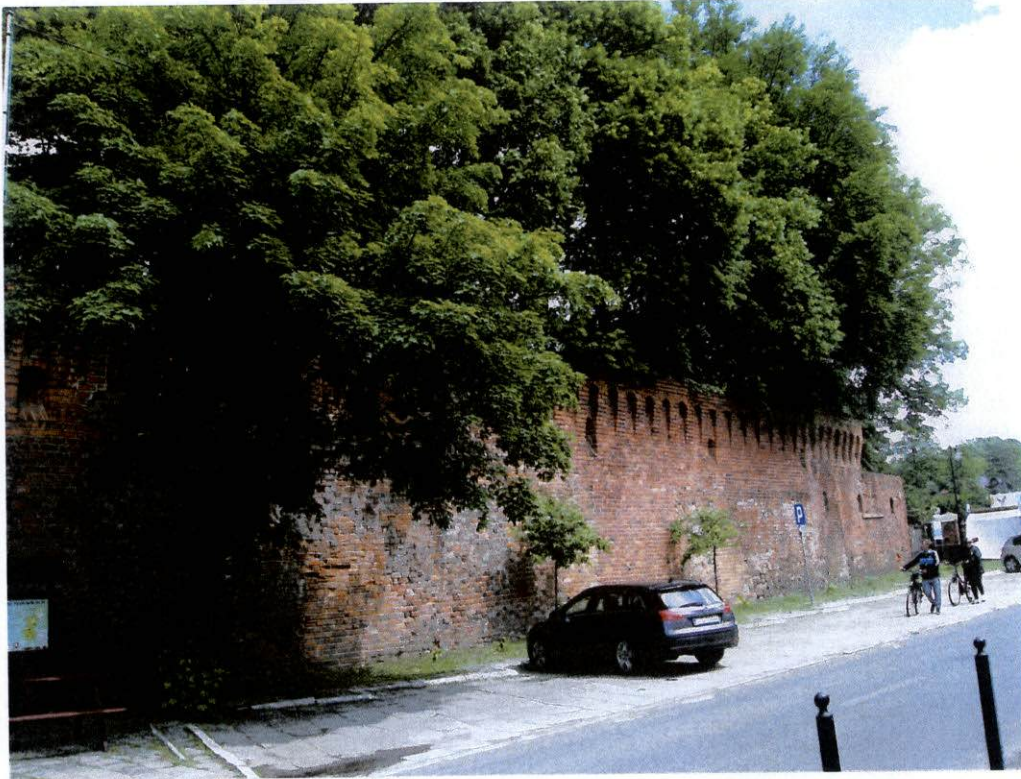
fot.13. Mur południowy – w widoku od strony ulicy Kościuszki. Po prawej stronie, przy narożu południowo – wschodnim, jest widoczny znacznie niższy fragment muru. W murze ceglany w wielu miejscach widoczne ślady napraw i przemurowań. Od strony wewnętrznej, bezpośrednio przy murze porastają liczne drzewa.
