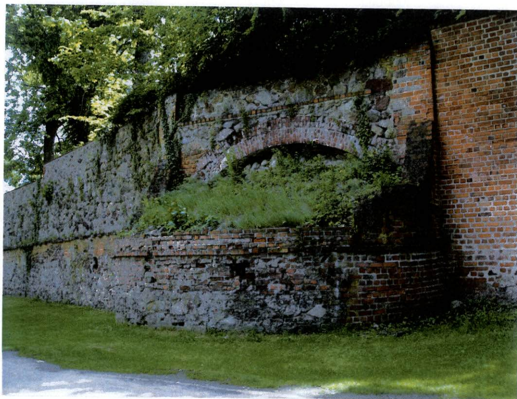
fot.50. Mur zachodni – bastion w środkowej części muru. Widoczny zachowany łęk ceglany w murze nad wejściem do bastionu. Zachowana dolna partia ściany bastionu. Nad łękiem część cegieł jest skorodowanych z głębokimi ubytkami, głębokie ubytki zaprawy. W dolnej zachowanej ścianie bastionu liczne cegły są głęboko skorodowane z głębokimi ubytkami. Na ścianie bastionu po prawej stronie widoczne współczesne przemurowanie cegłą.
