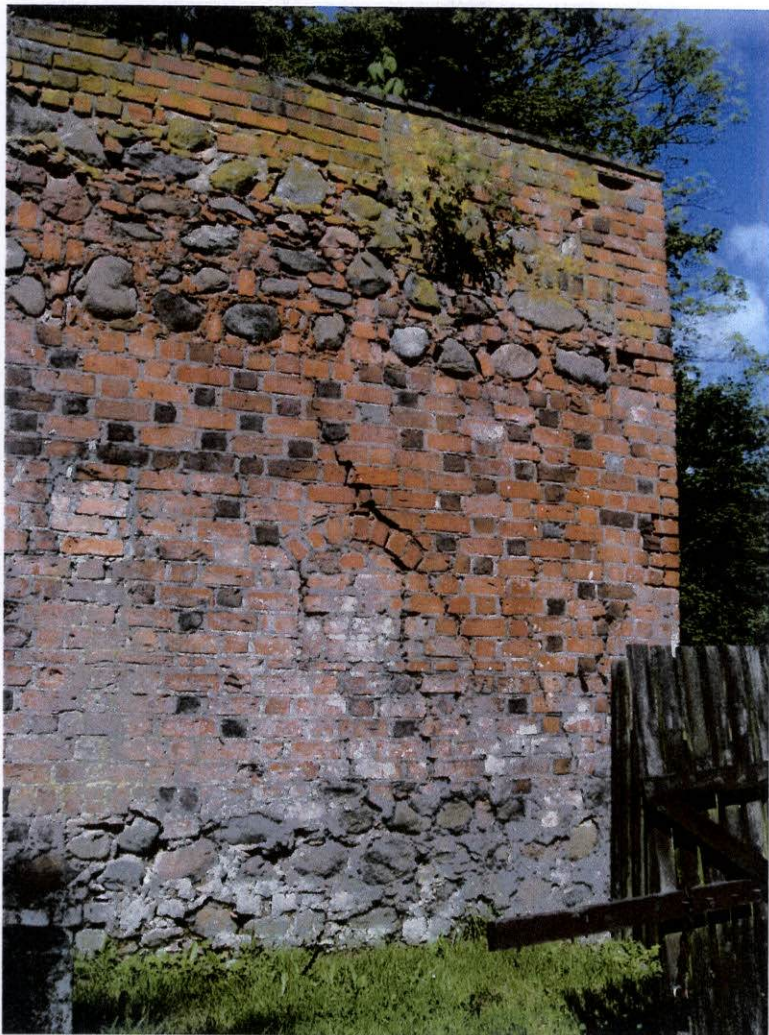
fot.31. Mur wschodni – naroże północne muru. Widoczne dołem i górá kamienie otoczaki. Przy części kamieni są głębokie ubytki zaprawy. W murze ceglanym są liczne ukośne spękania.
