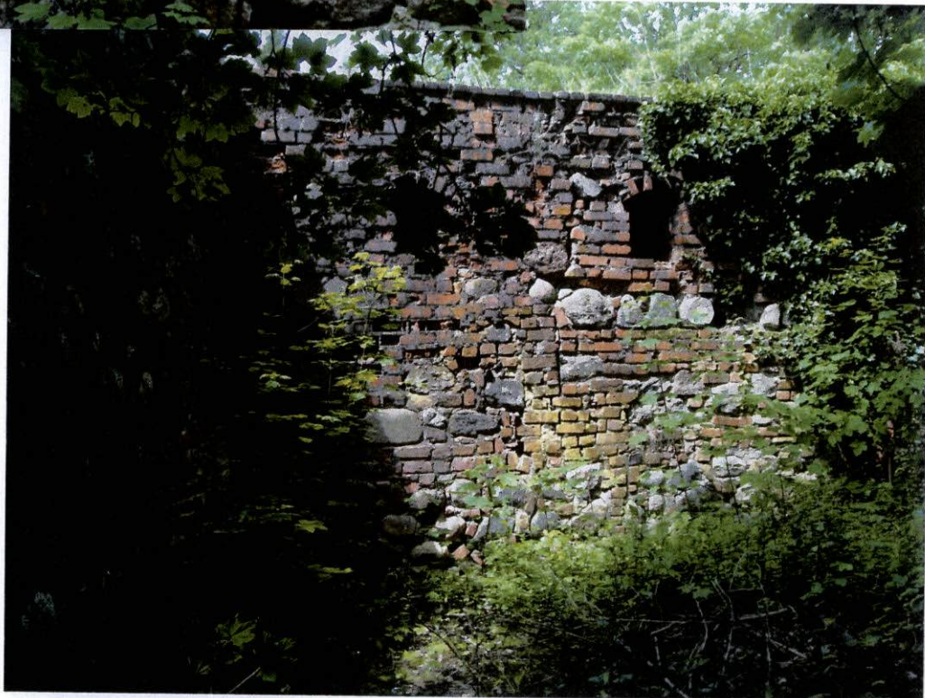
fot.12. Naroże południowo – zachodnie – mur zachodni w sąsiedztwie naroża w widoku od strony wewnętrznej. Widoczne pionowe pęknięcia na całej wysokości muru oraz głębokie ubytki zaprawy. Poziom terenu widoczny na zdjęciu znajduje się około 4,00 m wyżej niż teren po zewnętrznej stronie muru, co skutkuje naporem gruntu na mur. Mur o zmniejszonej nośności w wyniku wieloletnich procesów starzenia się cegły i zaprawy, znacząco przyśpieszonych zawilgoceniem, nie jest w stanie przenieść działającego naporu gruntu.
