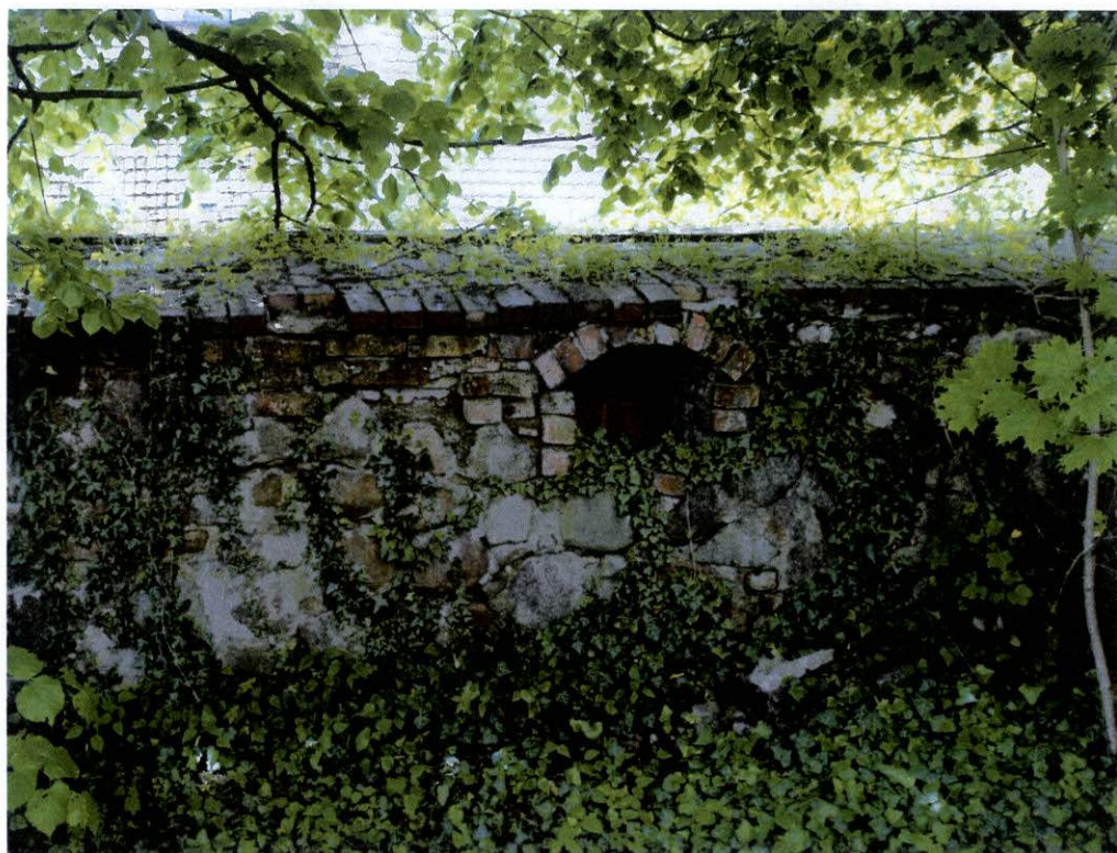
fot.22. Mur południowy – mur z cegły i kamieni łamanych. Część cegieł jest nie związanych zaprawą, skorodowanych z ubytkami, głębokie ubytki zaprawy. Na murze porasta zieleń. Widoczny wysoki poziom terenu od strony wewnętrznej muru. Różnica wysokości terenu po obu stronach muru różnie się kształtuje, można przyjąć że średnio wynosi około 4,00 m.
