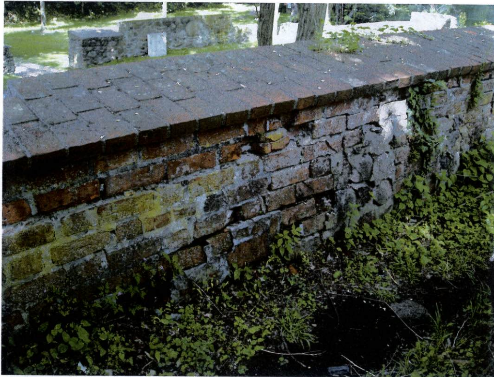
fot.54. Mur zachodni – mur w części północnej. Widoczne liczne cegły odsadzone i nie związane z murem. Część cegieł jest skorodowanych z ubytkami, głębokie ubytki zaprawy. Na koronie muru nieliczne porosty, na koronie nie ma uszkodzeń.
