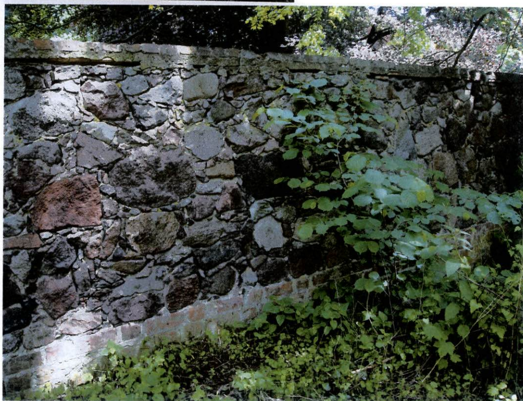
fot.44. Mur północny – wschodnia partia muru w widoku od strony wewnętrznej. Widoczny mur z kamieni łamanych, niżej z cegły. W murze ubytki zaprawy.
