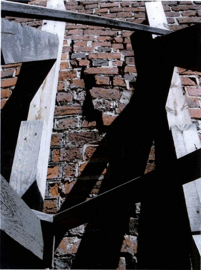
fot.9. Naroże południowo – zachodnie – zbliżenie pęknięcia pokazanego na fot.8. Widoczne znaczne wypchnięcie fragmentu muru na zewnątrz.
