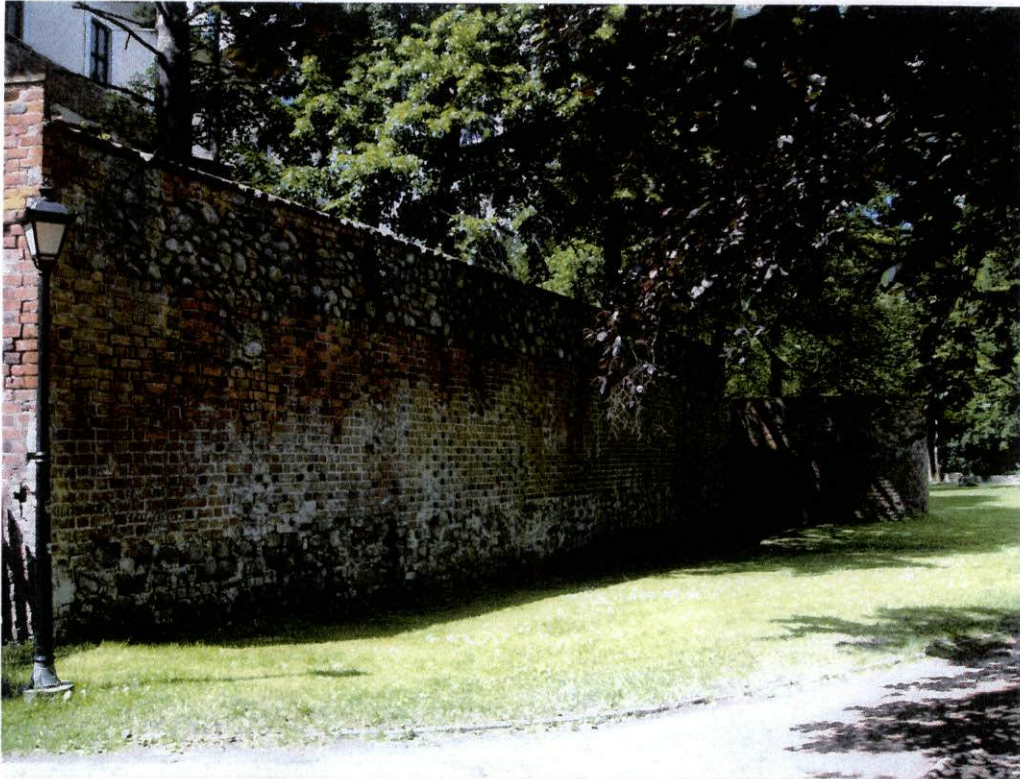
fot.37. Mur północny – widok części wschodniej. W górnej i dolnej partii mur z kamieni otoczaków, w partii środkowej mur z cegły. W górnej partii kamiennej oraz częściowo w partii ceglanej głębokie ubytki zaprawy. W głębi widoczna zachowana dolna część bastionu.
