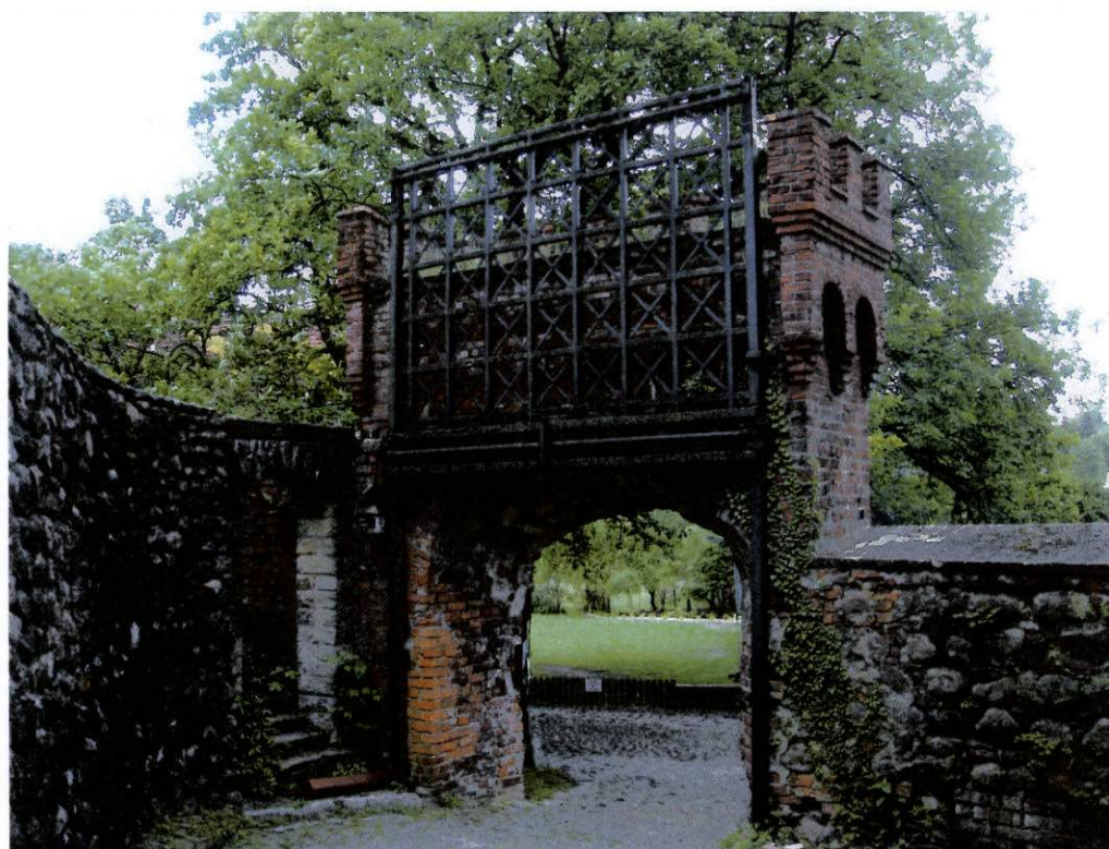
fot.26. Mur wschodni – brama wjazdowa na teren zamku, w linii muru obronnego, w widoku od strony wewnętrznej. W filarze bramnym widoczne pionowe pęknięcia. Obok uzupełnienia muru bramy cegłą współczesną, nie dobraną kolorystycznie. Po prawej stronie mur z kamieni otoczaków i cegły – ten sam mur jest na zewnątrz z cegły – fot.25.
