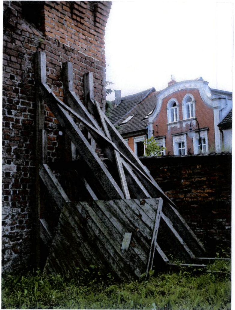
fot.7. Naroże południowo – zachodnie – widoczne stęplowanie drewniane prowizorycznie zabezpieczające spękaną i wypchniętą partię muru. W stęplowaniu połączenia ciesielskie elementów z użyciem gwoździ.
