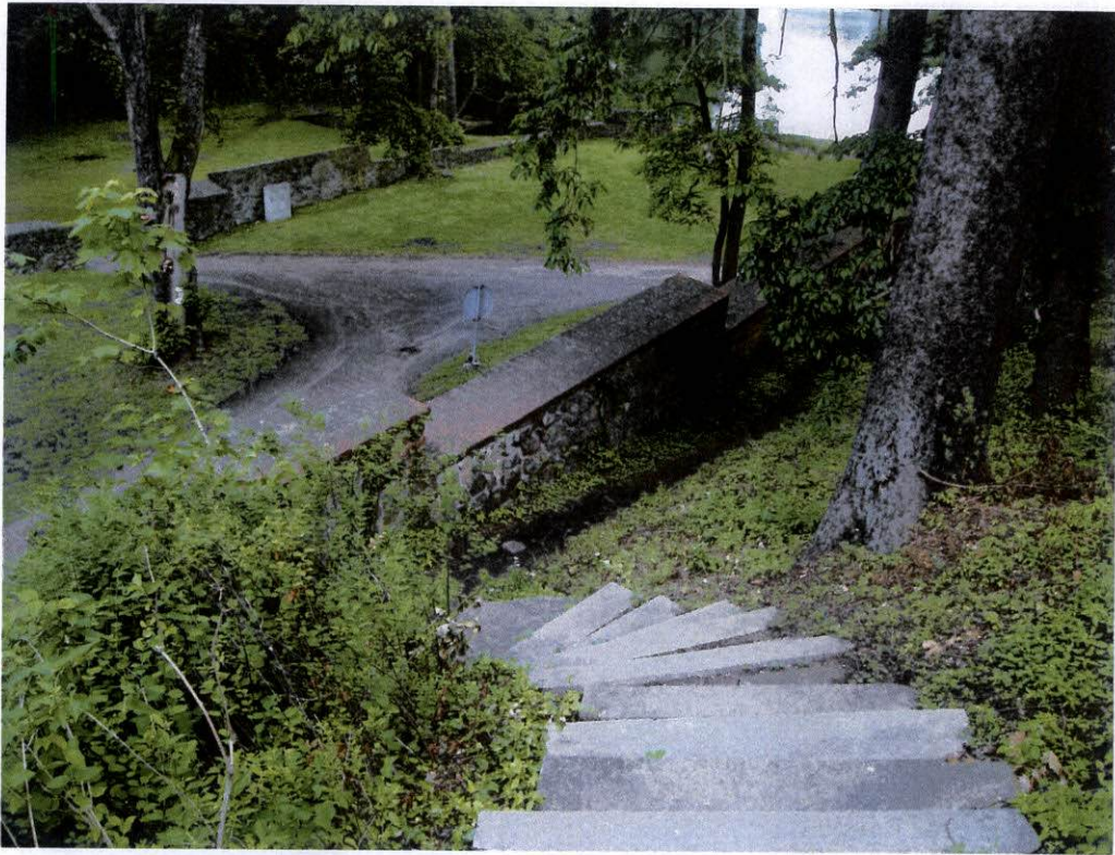
fot.53. Mur zachodni – północna partia muru w widoku od strony zewnętrznej. Poziom terenu od strony wnętrza jest zróżnicowany i w ekstremalnym przypadku znajduje się około 5,00 m wyżej niż teren po zewnętrznej stronie muru, co skutkuje naporem gruntu na mur. Napór gruntu jest tu tym większy, że przy murze jest stromy stok wzgórza zamkowego. Na koronie muru nieliczne porosty, na koronie nie ma uszkodzeń.
