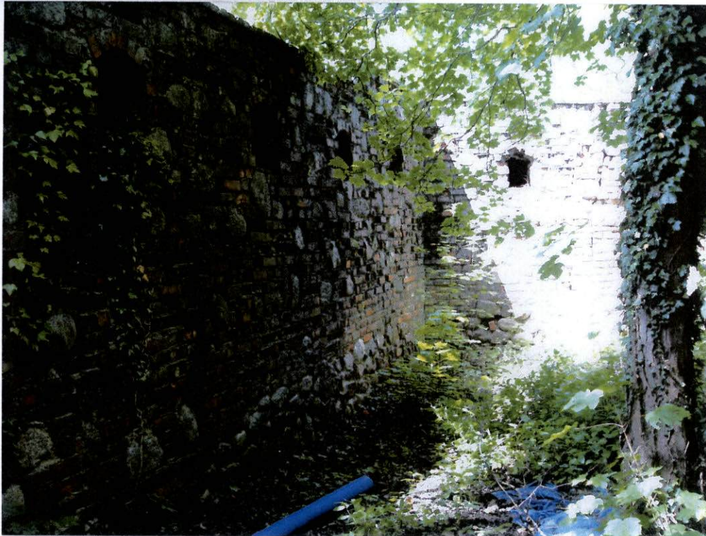
fot.10. Naroże południowo – zachodnie – w widoku od strony wewnętrznej. Po lewej stronie mur południowy z kamieni otoczków i cegły, z głębokimi ubytkami zaprawy. W głębi mur południowy z widocznym pionowym pęknięciem na całej wysokości.
