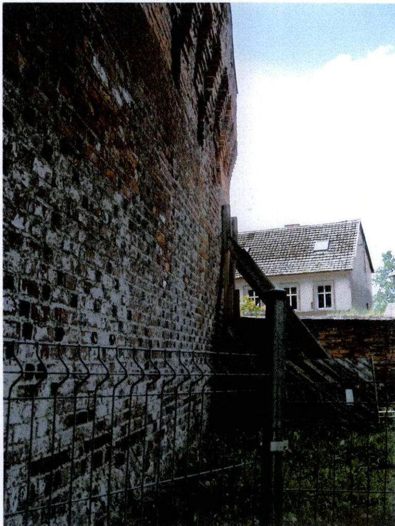
fot.4. Naroże południowo – zachodnie – mur zachodni z widocznym wypchnięciem środkowej partii.
