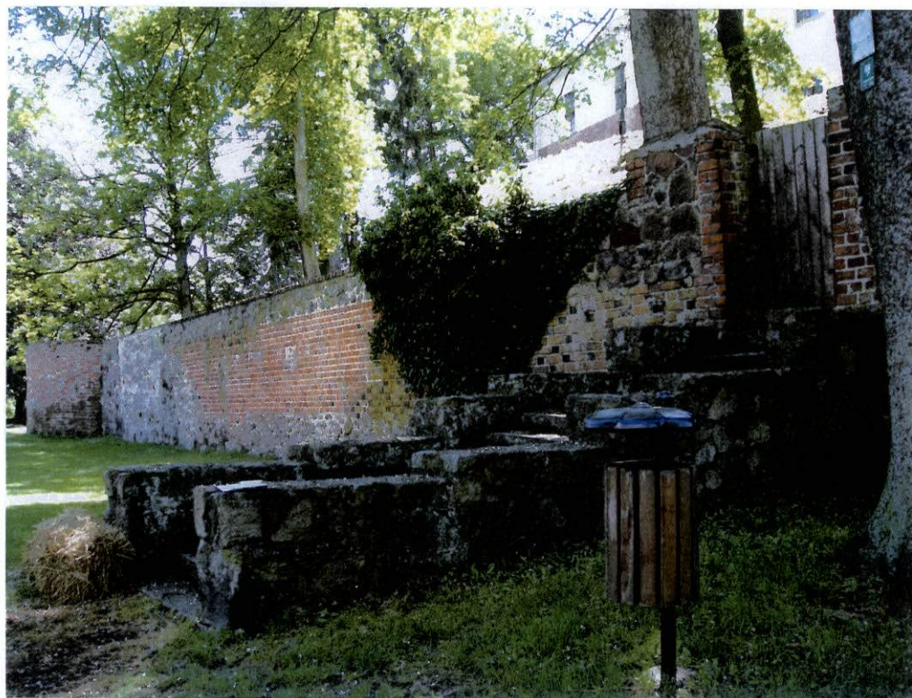
fot.40. Mur północny – widok części zachodniej. W górnej i dolnej partii mur z kamieni otoczaków, w partii środkowej mur z cegły. Na pierwszym planie schody kamienne i otwór wejściowy w murze. Schody bez uszkodzeń.
