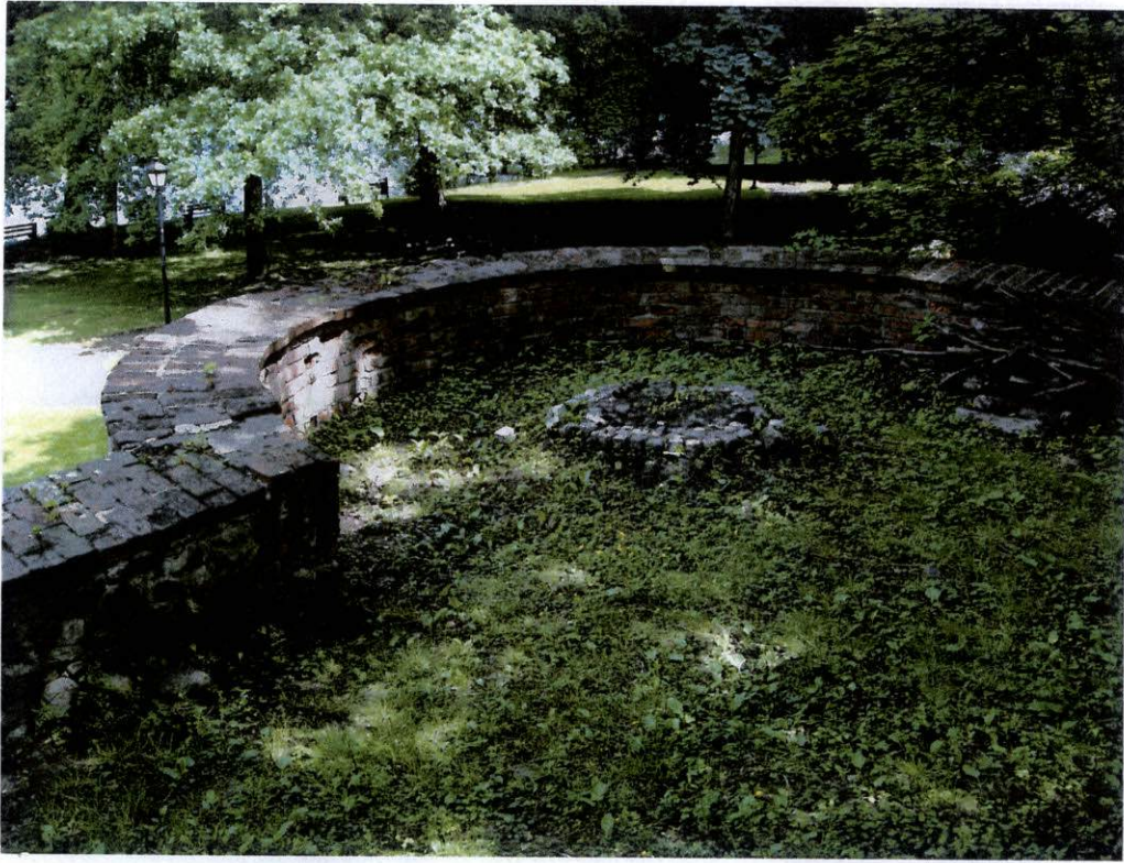
fot.45. Mur północny – zachowana dolna część bastionu, w widoku od strony wewnętrznej. W ścianie bastionu część cegieł jest skorodowanych z głębokimi ubytkami. Na koronie muru bastionu nieliczne porosty, miejscami zaprawa jest skorodowana. Bastion obecnie służy jako scena małego amfiteatru.
