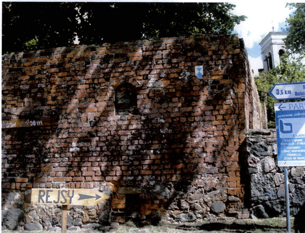
fot.18. Mur południowy – fragment wschodni muru. Widoczne liczne pionowe i ukośne pęknięcia muru, w tym pęknięcie w narożu na styku ściany południowej i wschodniej, przebiegające pionowo na całej wysokości muru.
