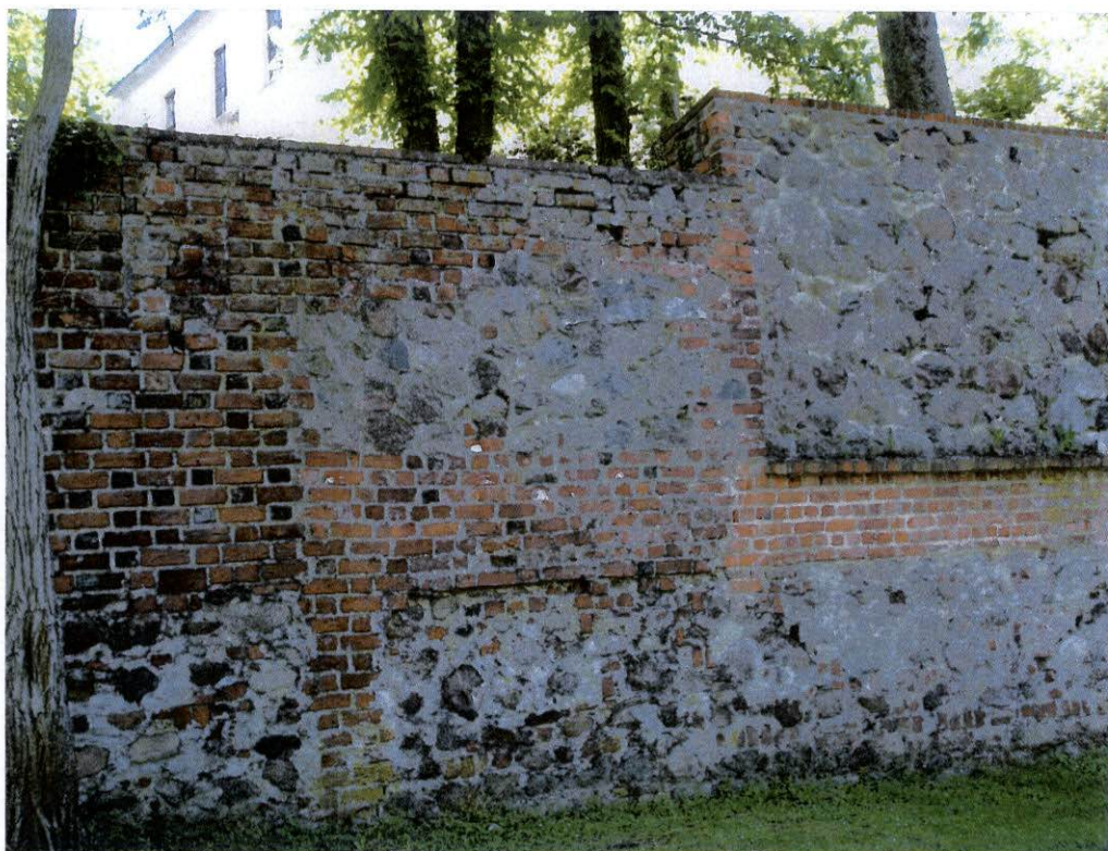
fot.49. Mur zachodni – fragment muru w części środkowej. Mur z kamieni otoczaków i kamieni łamanych, z przemurowaniami poziomymi i pionowymi z cegły. Górą pod koroną muru miejscowe głębokie ubytki zaprawy.
