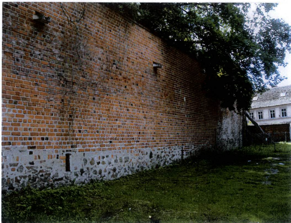
fot.51. Mur zachodni – widok części południowej. Widoczny mur z cegły, z nielicznymi ceglami skorodowanymi. W głębi widoczne naroże południowo – zachodnie murów, wyodrębnione z uwagi na duże zniszczenia, jako oddzielna pozycja niniejszej ekspertyzy.
