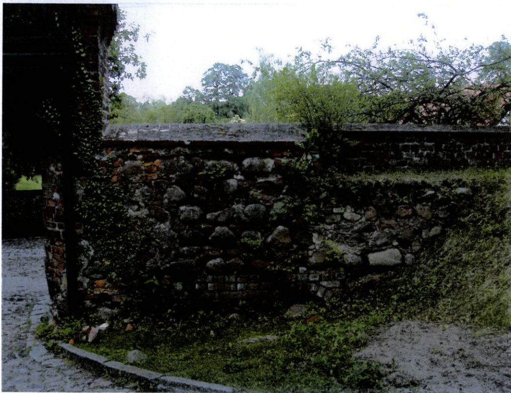
fot.32. Mur wschodni – mur z kamieni otoczaków i cegły, w widoku od strony wewnętrznej. Widoczne głębokie ubytki zaprawy, szczególnie w partiach muru z kamieni.
