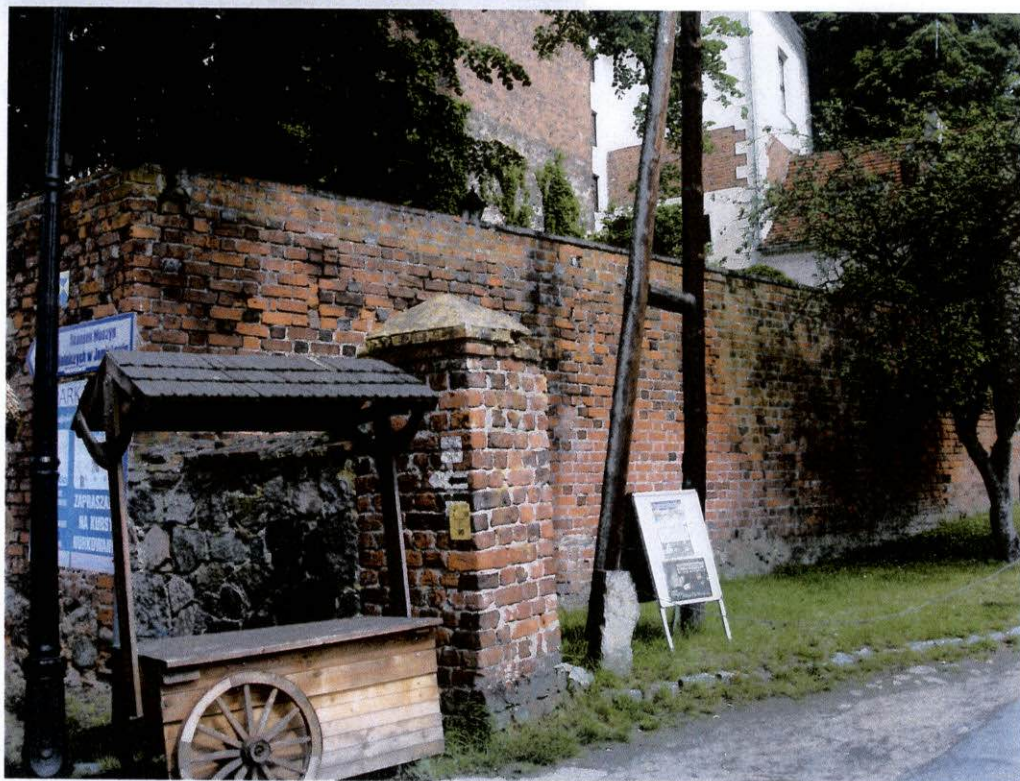
fot.28. Mur wschodni – południowa część muru obronnego z cegły, dołem kamienie otoczaki. W narożu murów wschodniego i południowego pęknięcie, górą o znacznej rozwartości.
