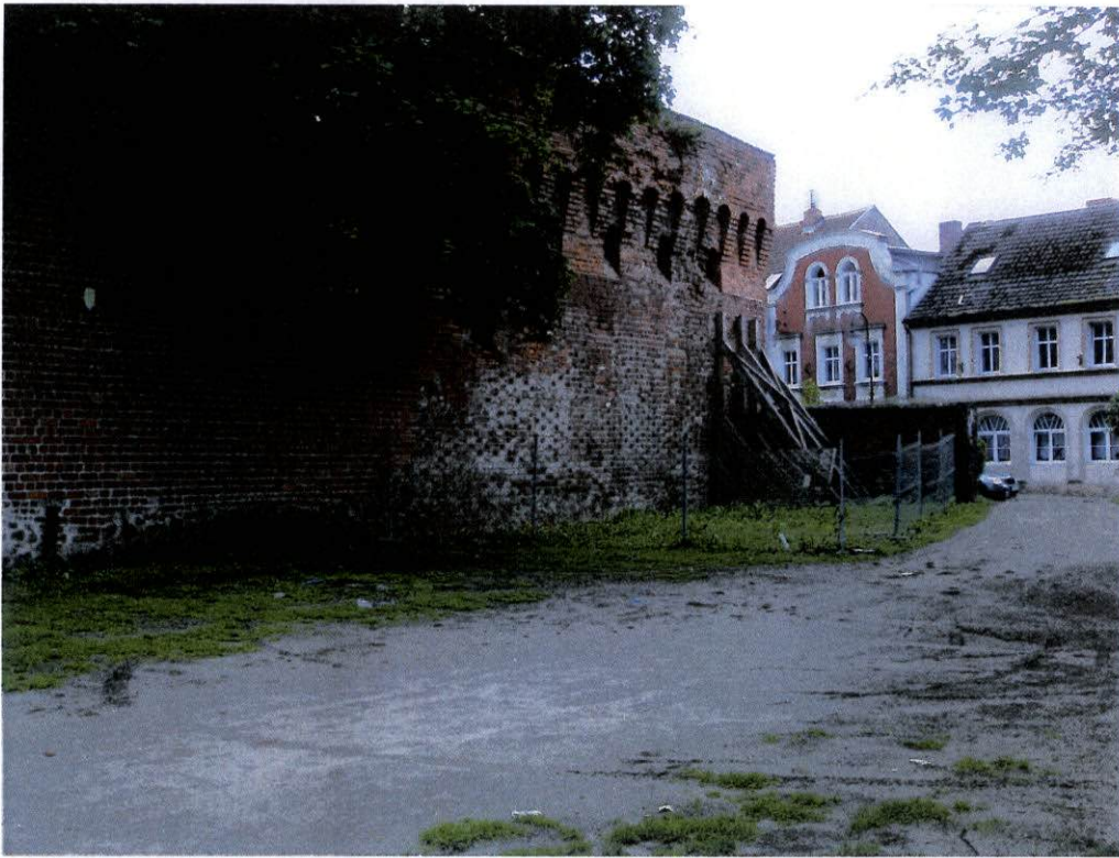
fot.3. Naroże południowo – zachodnie – widoczny mur zachodni w pobliżu naroża, w miejscu spękań i odkształcenia zabezpieczony stemplowaniem drewnianym.
