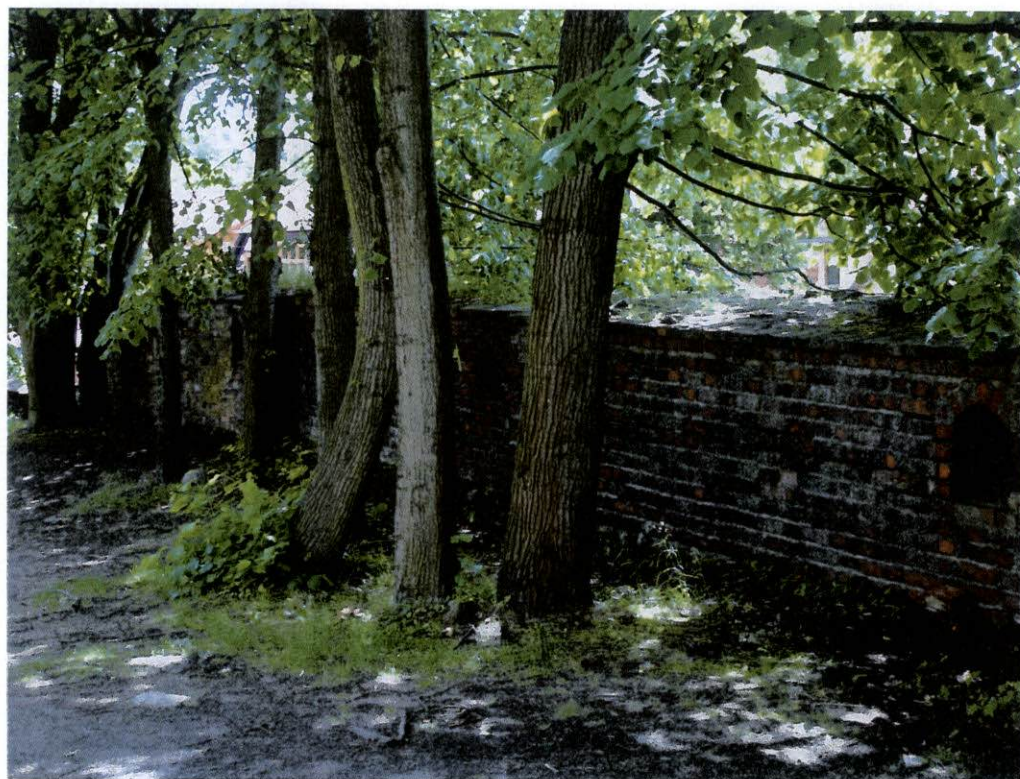
fot.20. Mur południowy - mur z cegły w widoku od strony wewnętrznej. Widoczne liczne drzewa rosnące w bezpośrednim sąsiedztwie muru i systemem korzeniowym uszkadzające mur. W murze liczne ubytki zaprawy. Na koronie muru liczne porosty.
